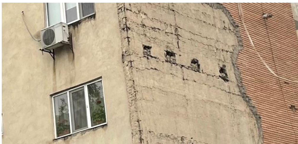
Figura 3: degradare tipică fatada
